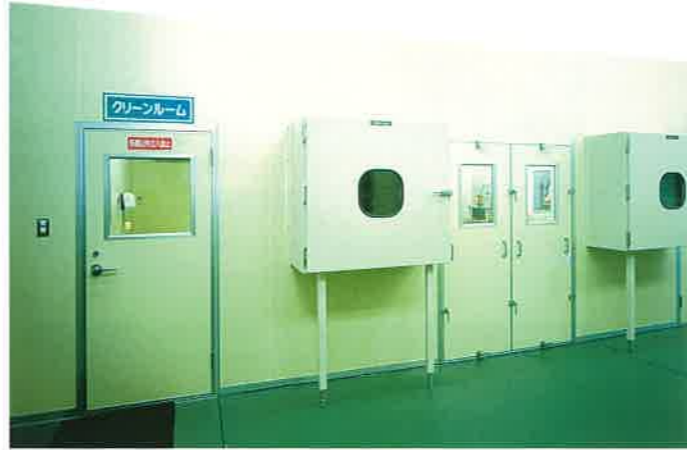
舞鶴工場のクリーンルーム
